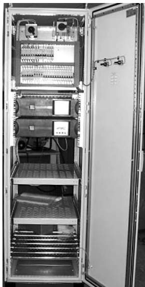
Рис. 6. Внешний вид шкафа с источником бесперебойного питания без установленных батарей
